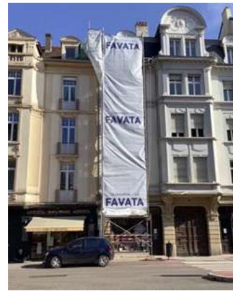
Figure 109 : Enseigne temporaire apposée sur des échafaudages des bâches de chantiers (enseignes a priori conformes au RNP), Metz, printemps 2021
